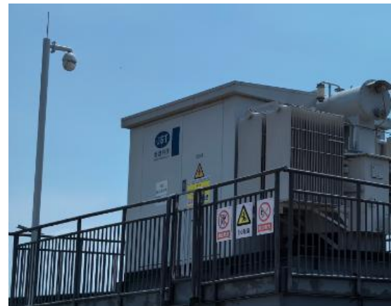
光伏场区摄像头
