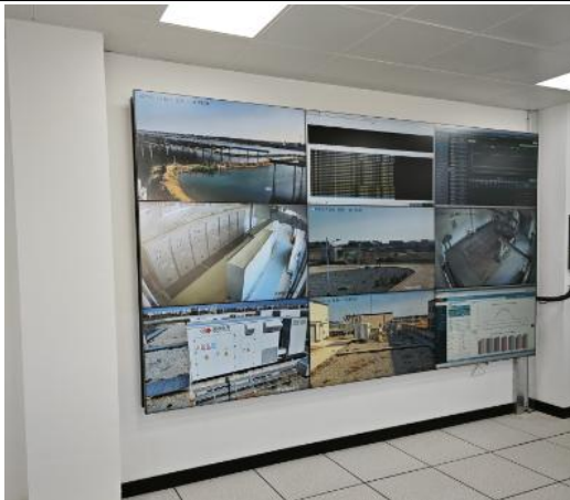
升压站视频监控
